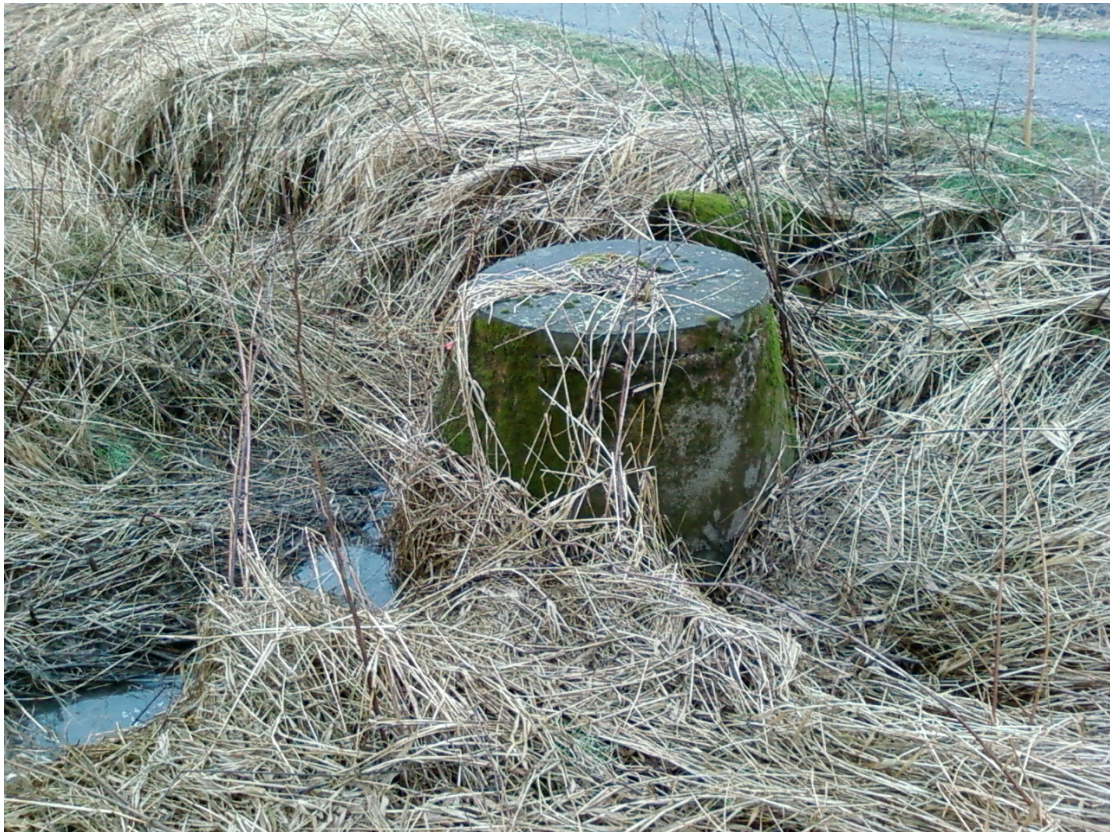
Erosjon rundt utett kum. Foto: Gørli Bruun Andersen
