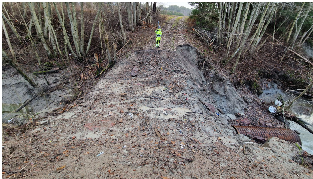
Figur 27. Kulverten under jordbruksvei ved Nordre Valle, innløp til venstre. Kulverten er skjøtet på i utløp. På bildet er veien senket ca. 1,5 meter etter flommen i 2025. Bilde: NVE
