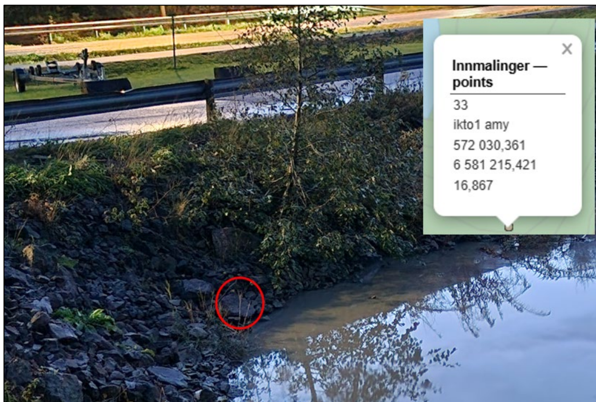
Figur 20. Vannstand oppstrøms Bispeveien 4. oktober, rett før det ble mørkt. Koten er målt inn til 16,8 moh. 15.12.2025
