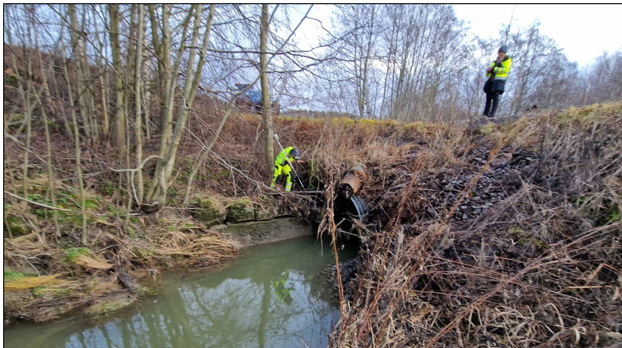
Figur 28. Innløp kulvert ved Søndre Valle. Bilde: NVE
