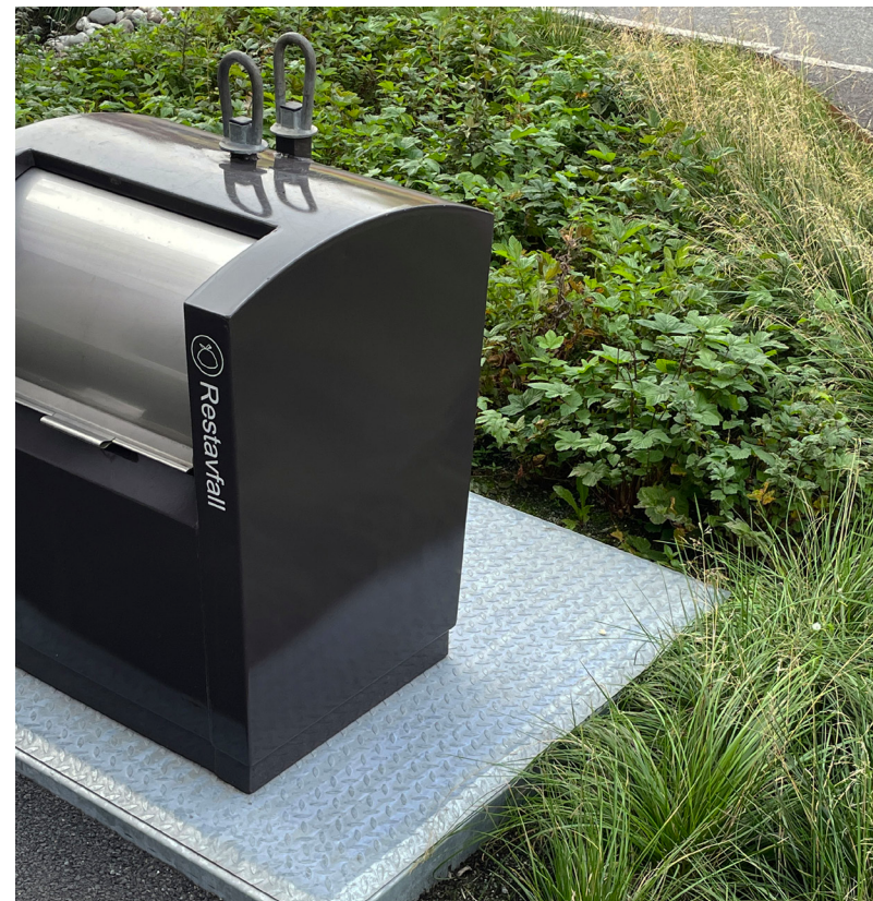
Nedgravde containere innarbeidet i frodige bed
